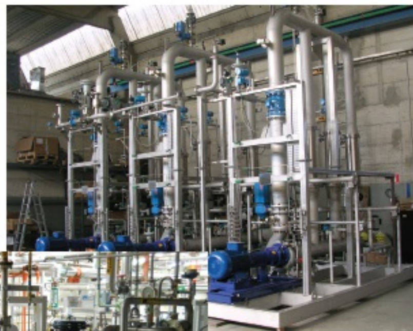
Impianto di ultrafiltrazione ceramico per recupero di sostanze organiche
